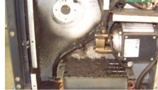
Vervuilde machine door metaalstof
