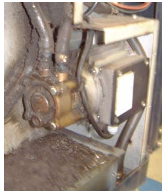
Kortsluiting door lekkage
