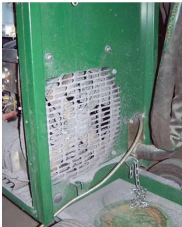
Belemmering luchttoevoer door vervuiling
